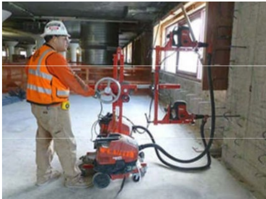
Foto cortesía de la Universidad de California, Berkeley (D. Rempel)
