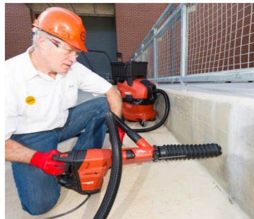
Empleado taladrando en concreto con un martillo perforador equipado con una cubierta y un sistema de eliminación de polvo
